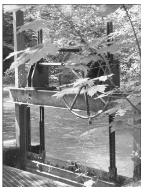
Vanne à la prise d'eau du canal des Usiniers (photo CDM)
